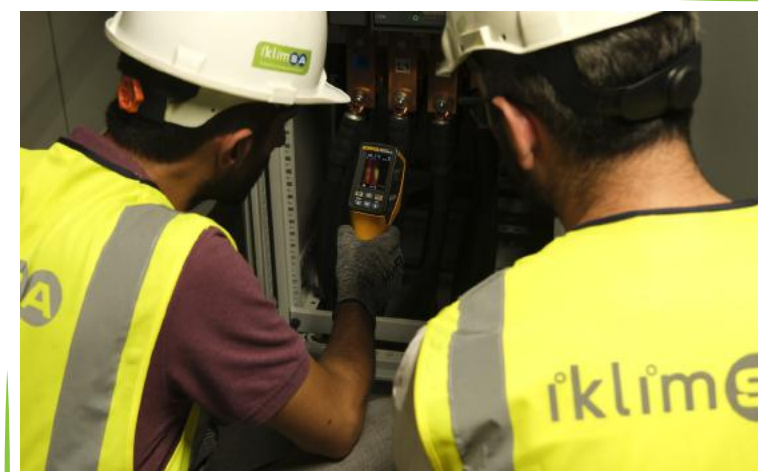
Termal Kamera ile Bağlantı Kontrolleri
